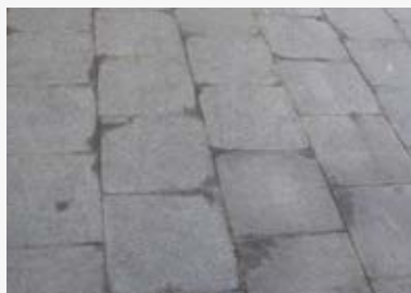
Feuchte im Unterbau
