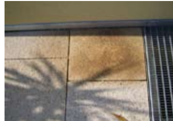
rostiger Splitt im Unterbau
