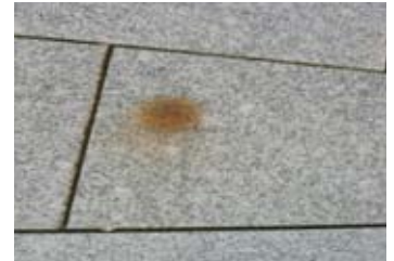
rostiger Splitt im Unterbau
